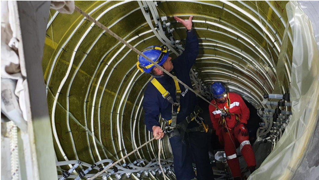
Figura 7. Proceso de infusión en un tramo inclinado de un sifón de agua potable.
