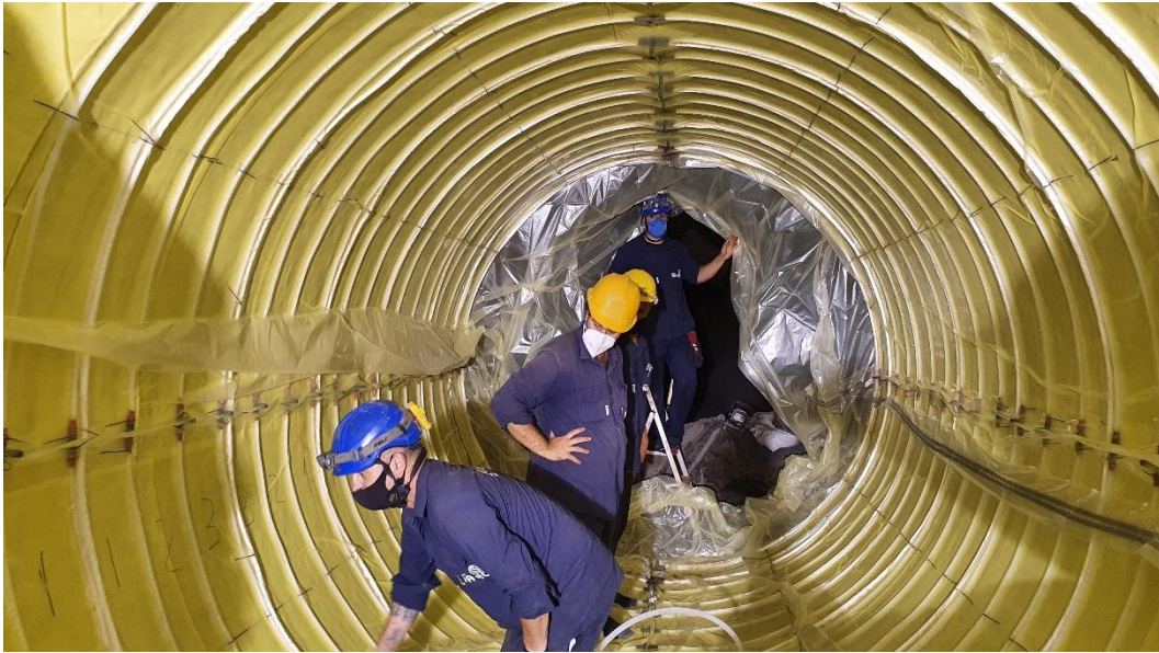
Figura 6. Distribución y sellado del sistema de regulación y control de infusión y vacío.
